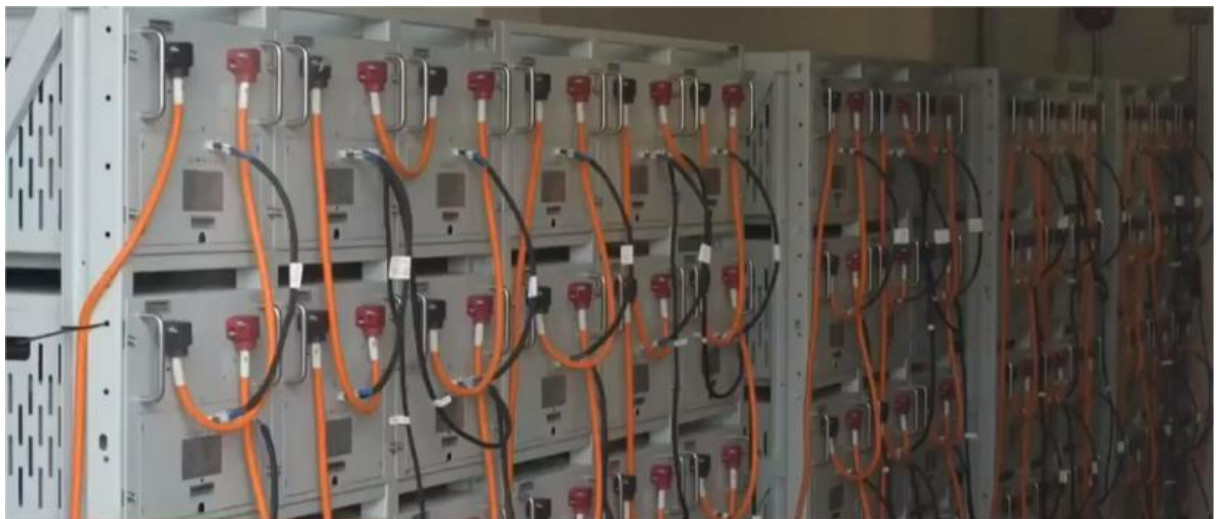
Solución de batería de litio de 1.182,72kWh de ATESS
